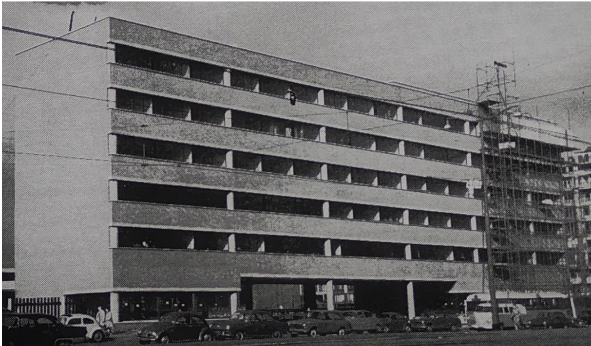
Afbeelding 70: Rotterdam, Het eerste deel van het Kruispleingebouw , nog in aanbouw, 1963-1965, Bureau Boks Eijkelenboom Middelhoek (foto: Het Nieuwe Instituut, Rotterdam, Boks , J.W.C. (Joost Willemsen Cornelis) / Archief, nummer toegang BOKS 0188, inv.nr. 289d1. Middelhoek, "Kantoorgebouw voor de N.V. Bouw Internationaal Centrum," Weena 700 4 (1965)5: 1.).
